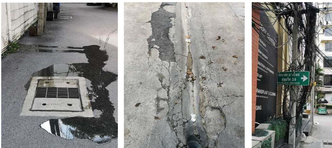
左から「民家からの排水」「放置された破損」「ぶら下がる電線」（筆者撮影）
