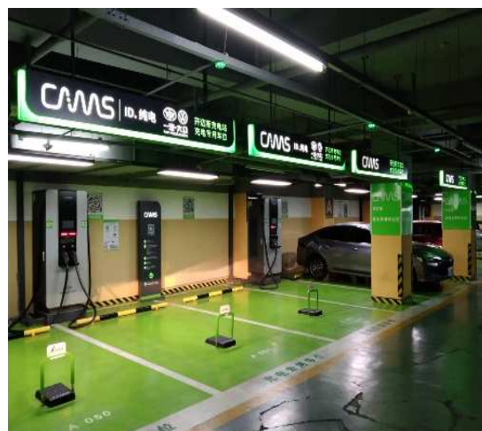
商業施設地下充電スタンド
